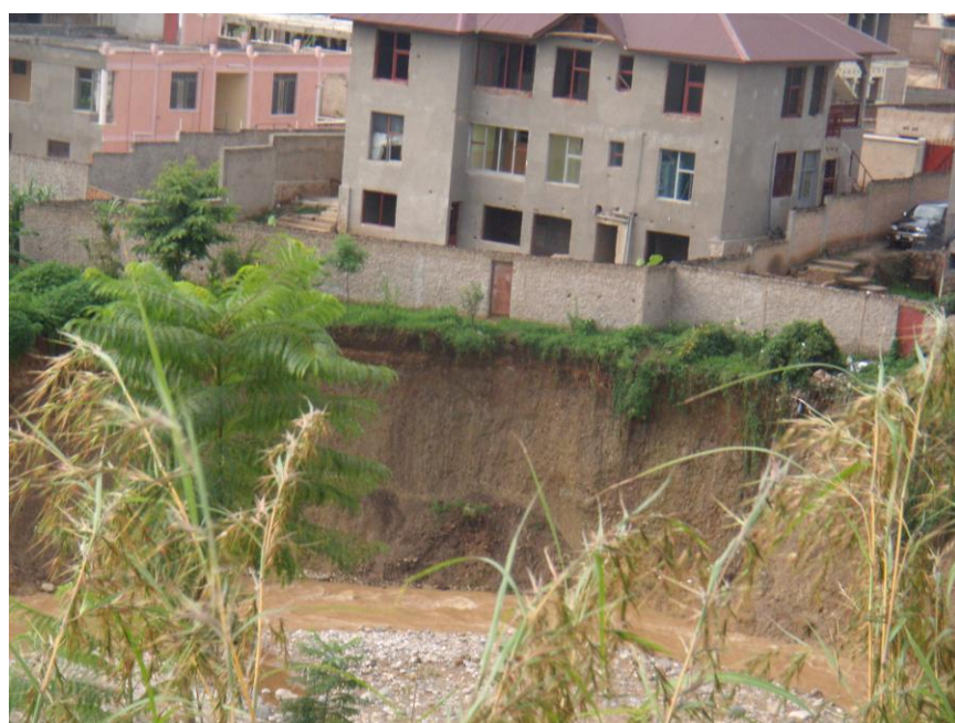
Photo n°2. Menace directe de destruction des maisons sur les rives de la Ntakangwa
