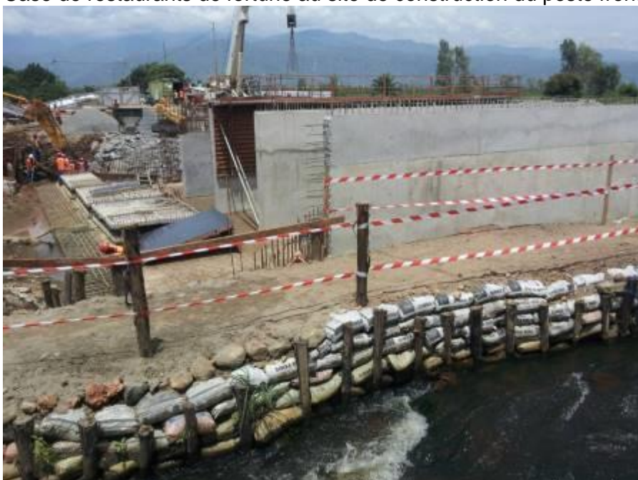
Construction du dalot sur la grande Rusizi à la frontière entre le Burundi et la RDC à Gatumba
