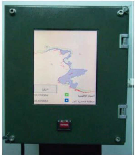
Figure 7 : Terminal d'interfaçage et de contrôle de l'U3C (source DGPA2013)
